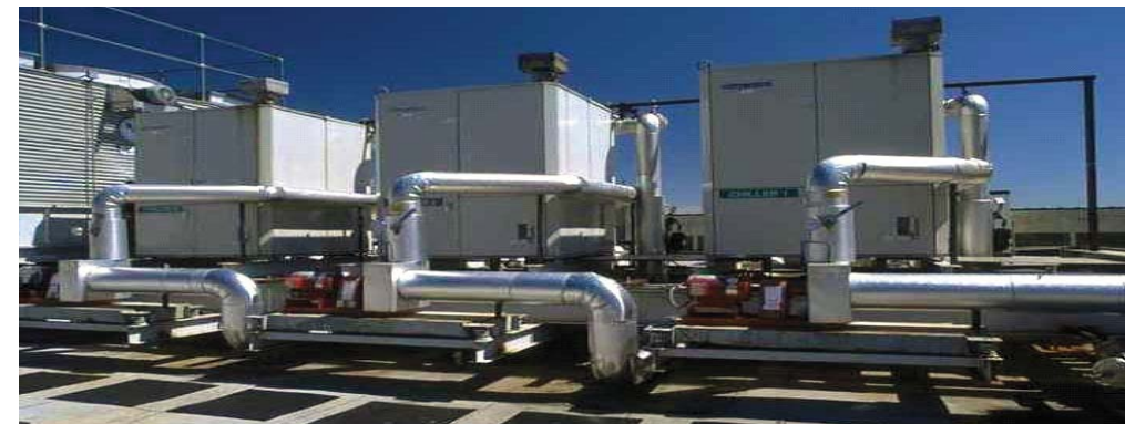
Unidades de enfriamiento por absorción.
